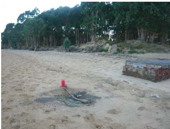
SOCAVONS PRODUCIDO POR LA ROTURA DEL TUBO, AFLORANDO A LA SUPERFICIE.
