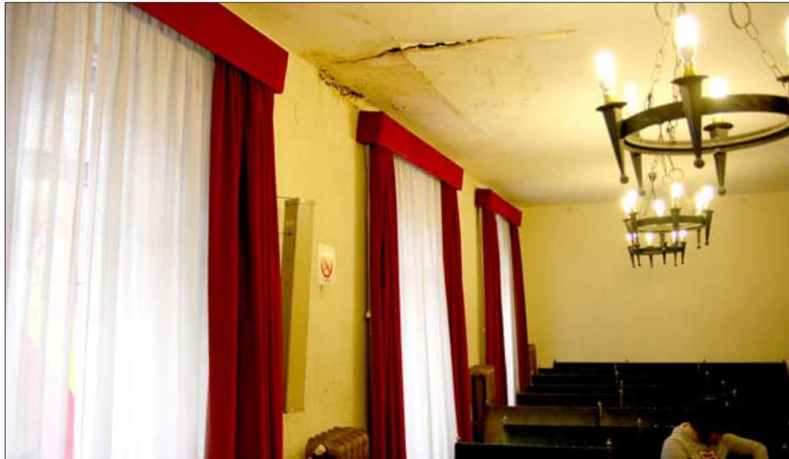
Estado que presenta el techo del salón de plenos del Ayuntamiento por las goteras. / BEDIA
